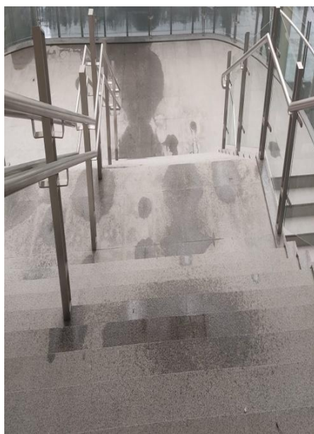
Figura 06: Identificação de vários pontos de acúmulo de água por goteira.
