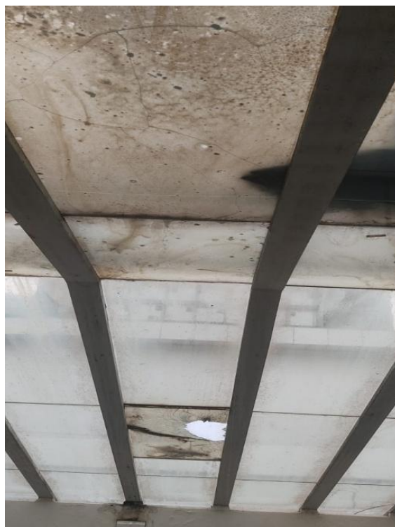
Figura 05: Vidro quebrado por queda de objeto durante a obra da recuperação da laje superior.
